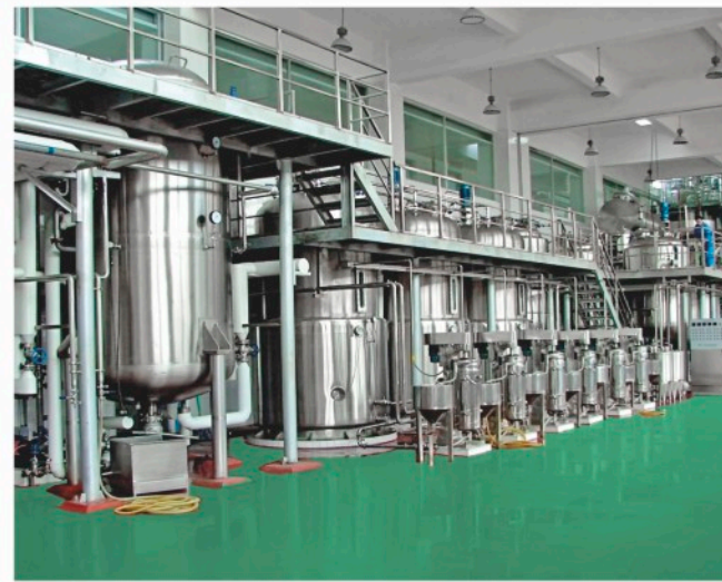
Sección de concentración Concentration section
